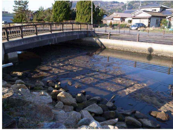
【図 38：汚泥の露出した水路と柵】
