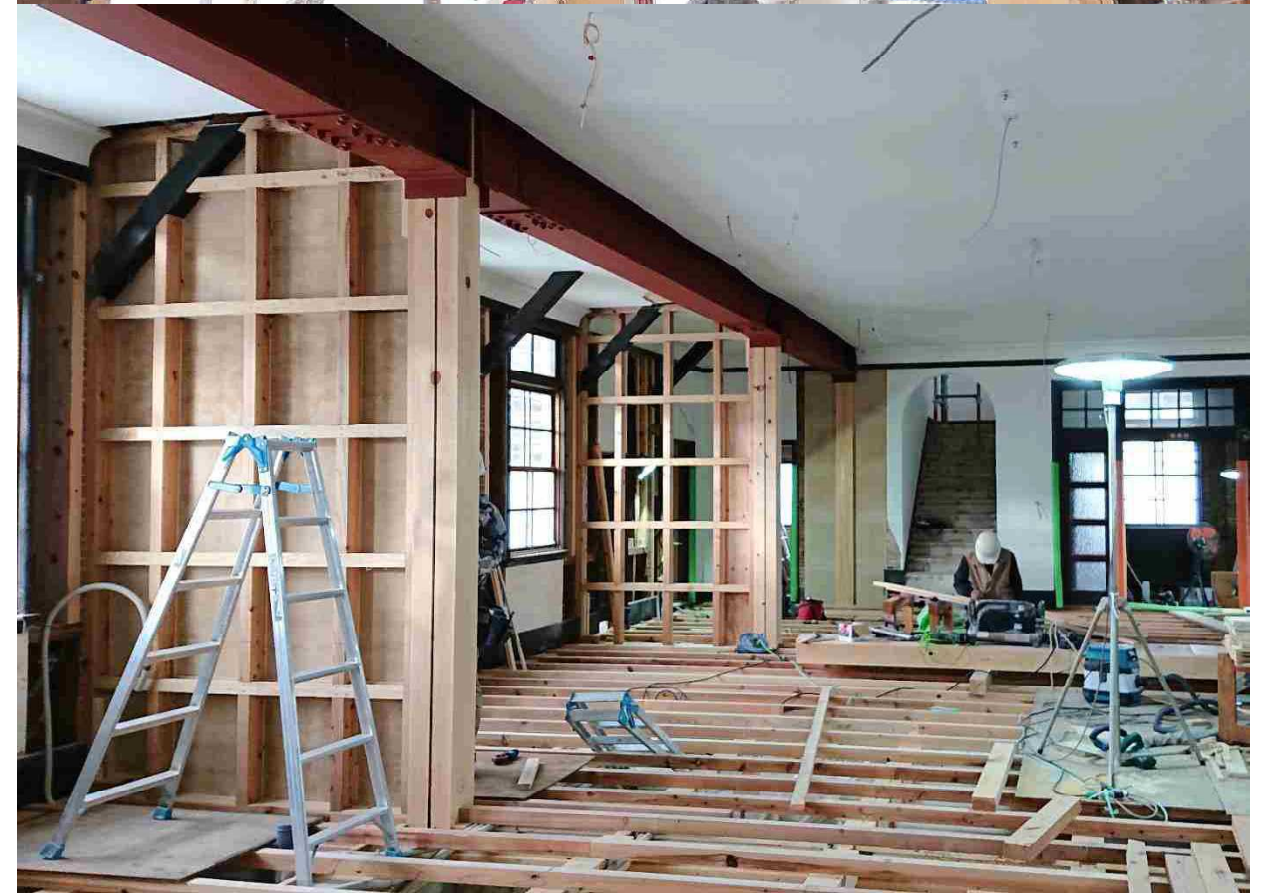
上／壁内部への雨水の侵入が原因で、腐朽や傷みが著しく危険な状態であった車寄せ。手前の木材は、修理中の倒壊を防ぐための仮設材です 下／新設した柱に付く袖壁。耐震対策の一つとして、柔剛性がある荒壁（土壁）パネルを張りました
