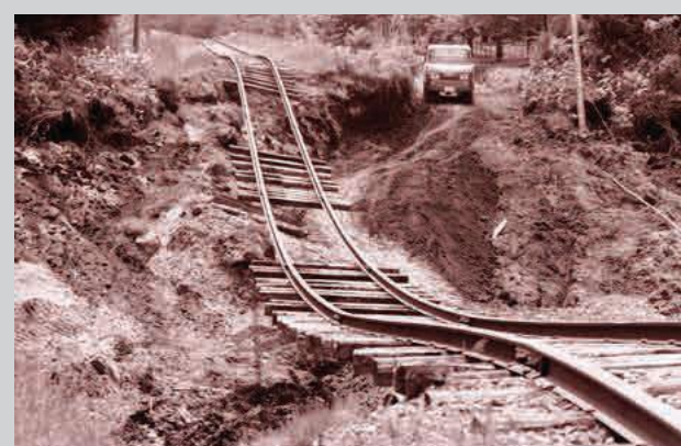
十勝沖地震で路盤（盛土）が流失した南部鉄道（写真：五戸町提供）
