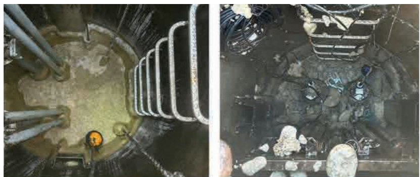
飲食店付近のマンホールポンプの状況【マンホールポンプに油脂類がたまっている（左）、油脂類が冷えて固まって団子状になっている（右）】
