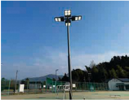
城山公園テニスコートのLED照明
