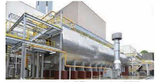
クリーンセンター内に設置してあるメタン発酵槽
