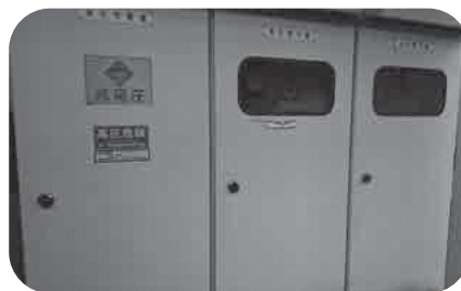
本庁舎のキュービクル（高圧受電設備）
