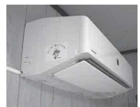
岩屋区で整備されたエアコン
