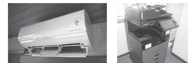
加悦奥区に整備されたエアコン(左)と複合機(右)
