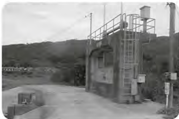
問題の樋門(石川 亀山川)
