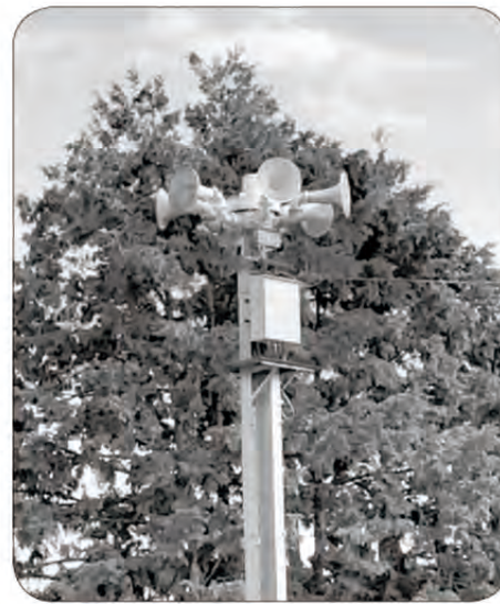
危険を知らせるサイレン
