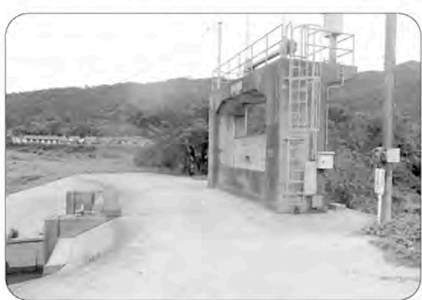
低すぎる逆流防止樋門
