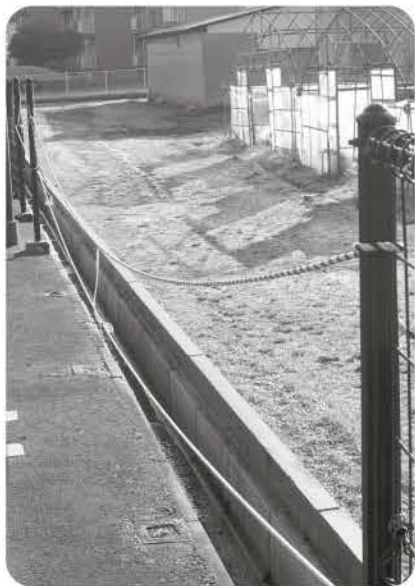
壊れたフェンス
