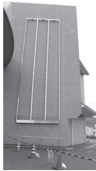
危険なタイル壁
