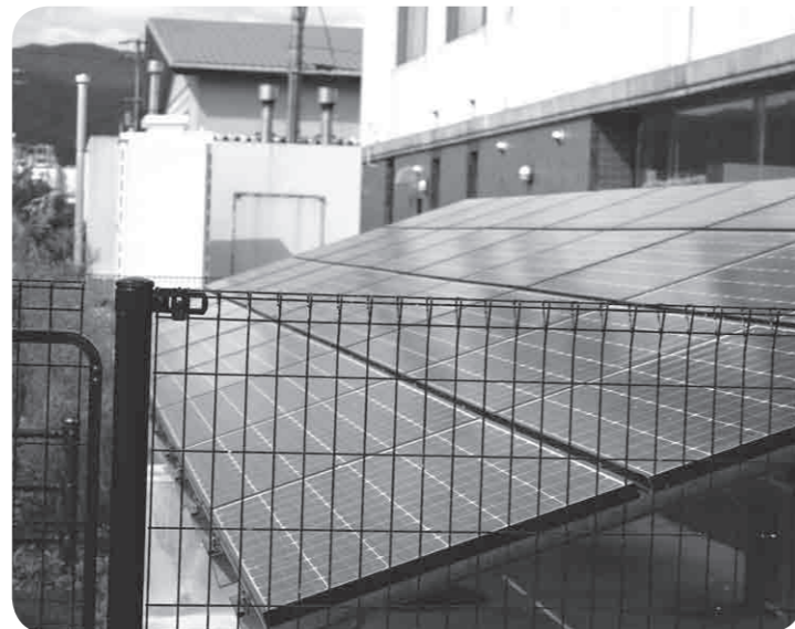
自家発電太陽光発電施設（わーくぱる）
