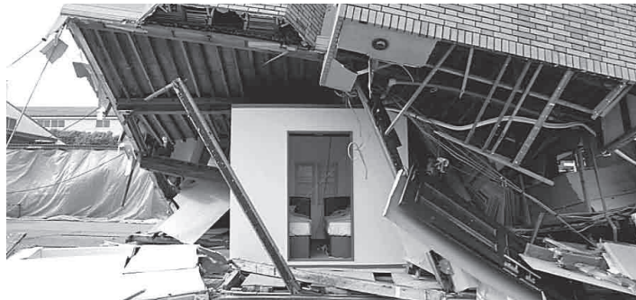
強固な耐震シェルター
