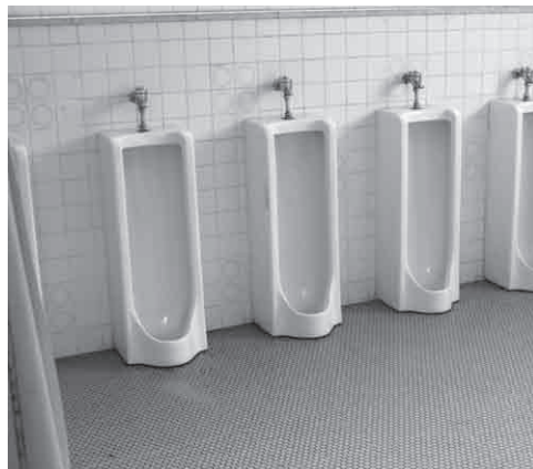
改修を待つトイレ
