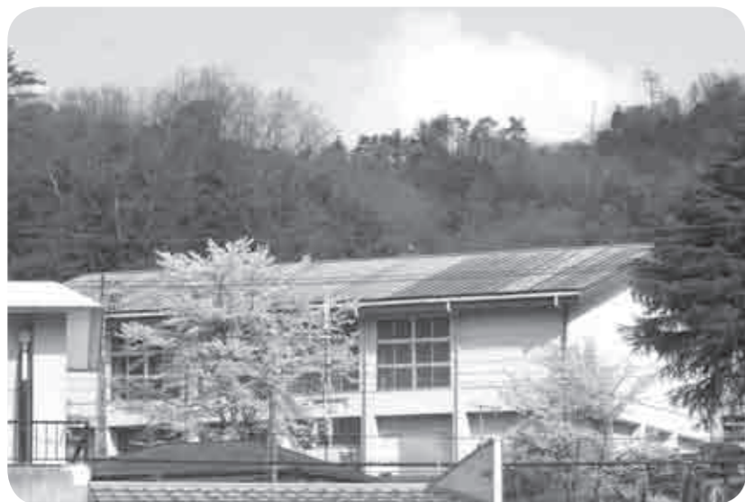
さびた屋根・早い修繕を
