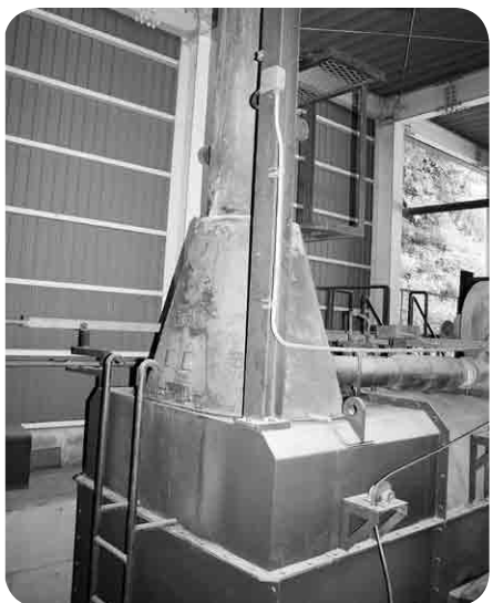
岩滝最終処分場の焼却炉
