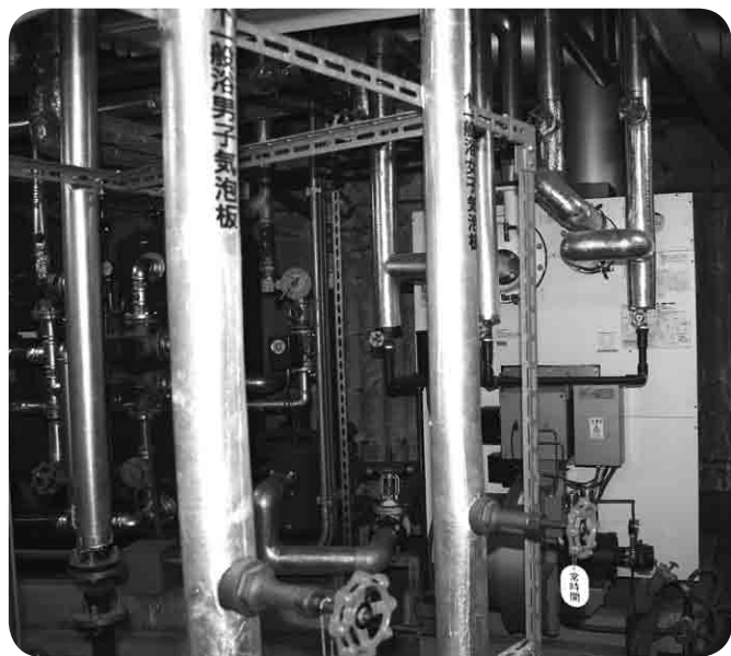
リフレの重油ボイラー
