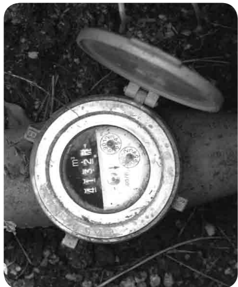
水道メーター
