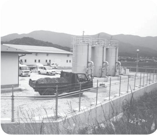
設備整備が進む簡易水道（算所浄水場）
