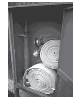
筒先やホースを格納している消火栓ボックス
