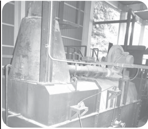
岩滝の最終処分場の焼却炉
