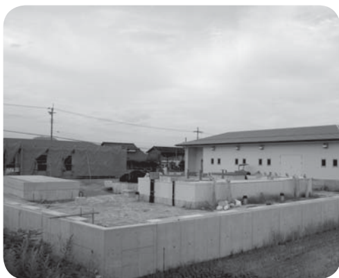
上水と簡水の統合に向けて（加悦浄水場）
