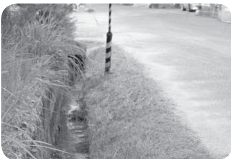
改修が望まれる側溝
