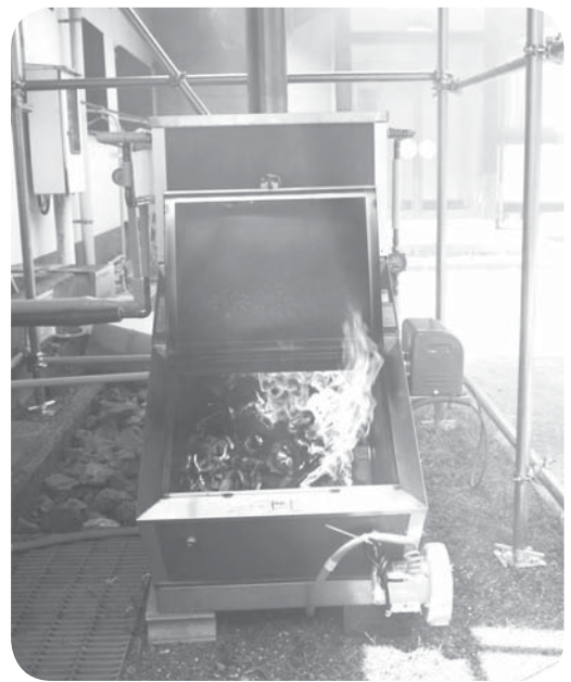
ウッドボイラーで竹を燃焼
