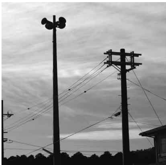
改修される防災無線
