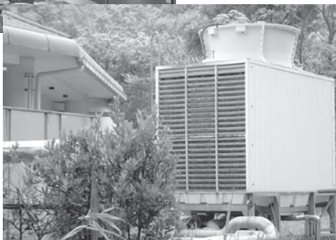
大型クーラー室外機
