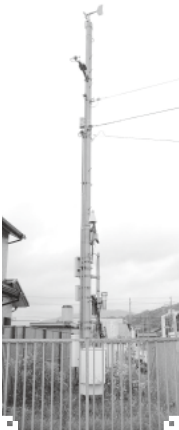
加悦派出所横の雨量計測器
