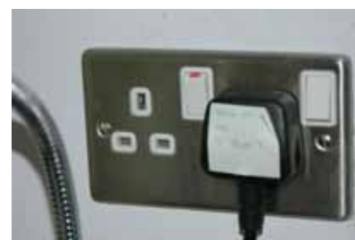
電気コンセント
